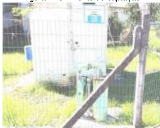
Figura IV-37: Ponto de captação
