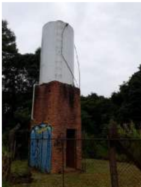
Figura 4-28: Poço Captação Bairro Picada 48 Alta (Fonte: Água de Ivoti)
