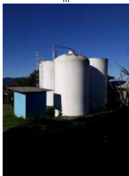
Figura IV-46: Reservatório água tratada 215 m 3
