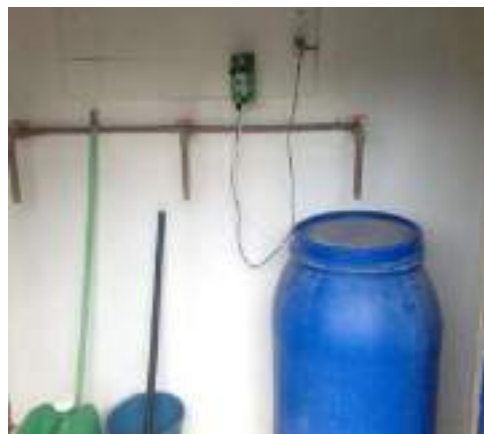
Figura 4-13: Sistema de cloração da Estação de Tratamento de Água (Fonte: Água de Ivoti)
