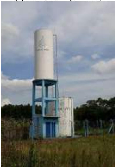
Figura IV-47: Reservatório água tratada 100m 3 (apoiado) 60m 3 (elevado)
