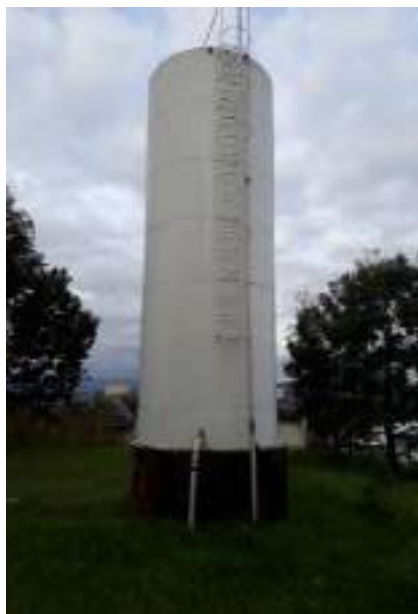
Figura 4-19: Reservatório água tratada 30m 3 (Fonte: Água de Ivoti)
