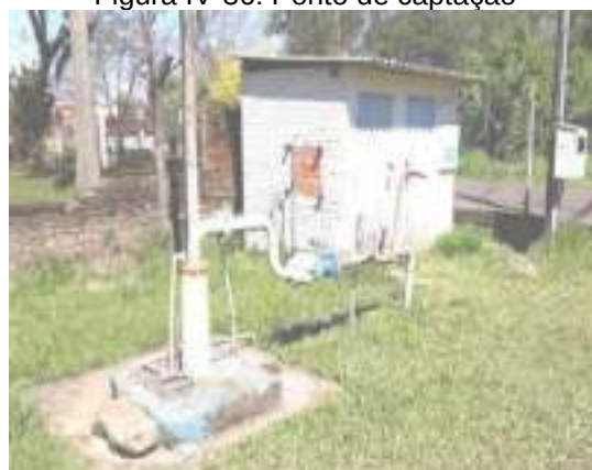
Figura IV-36: Ponto de captação
