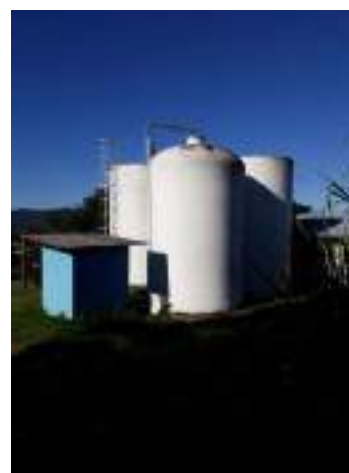
Figura 4-17: Reservatório água tratada 215 m³ (Fonte: Água de Ivoti)
