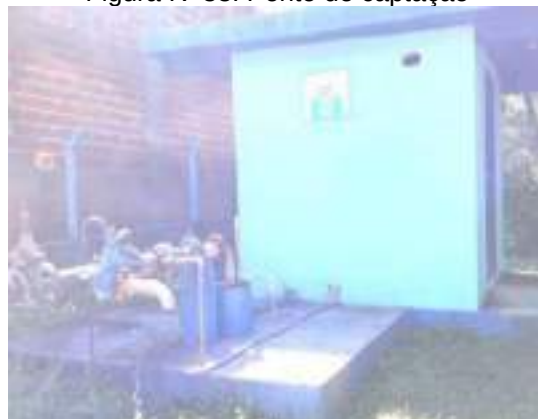
Figura IV-38: Ponto de captação
