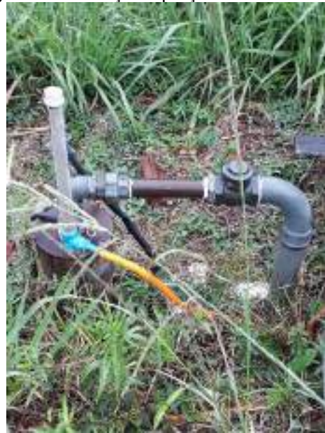
Figura IV-60: Poço Captação Bairro Nova Vila
