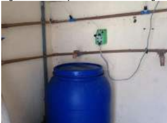
Figura IV-40: Estação de Tratamento de Água
