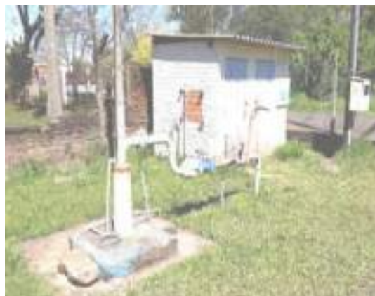
Figura 4-7: Ponto de captação (Fonte: Água de Ivoti)
