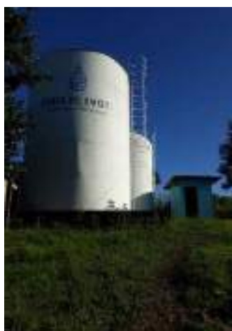
Figura 4-16: Reservatório água tratada 215 m³ (Fonte: Água de Ivoti)
