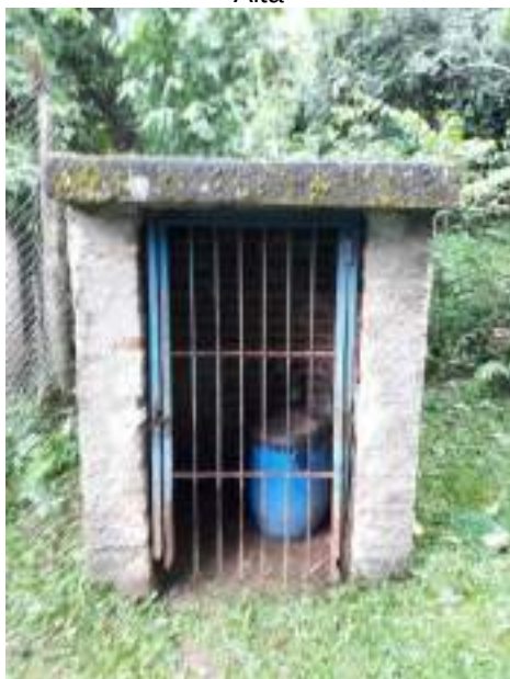
Figura IV-55: Poço Captação Bairro Picada 48 Alta
