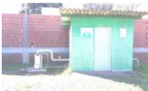
Figura 4-10: Estação de Tratamento de Água (Fonte: Água de Ivoti)
