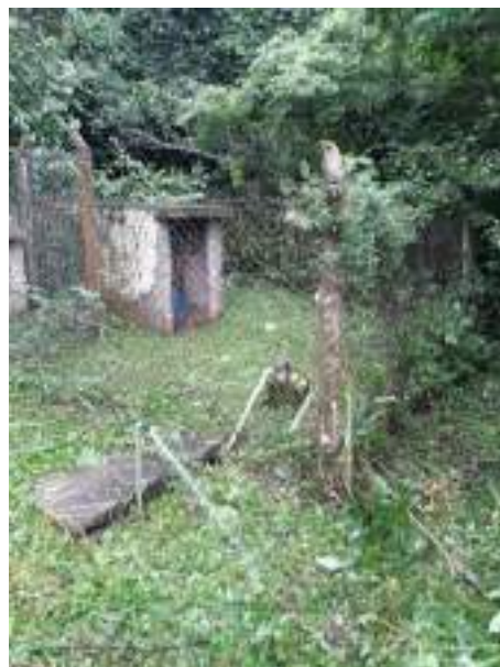
Figura 4-25: Poço Captação Bairro Picada 48 Alta (Fonte: Água de Ivoti)
