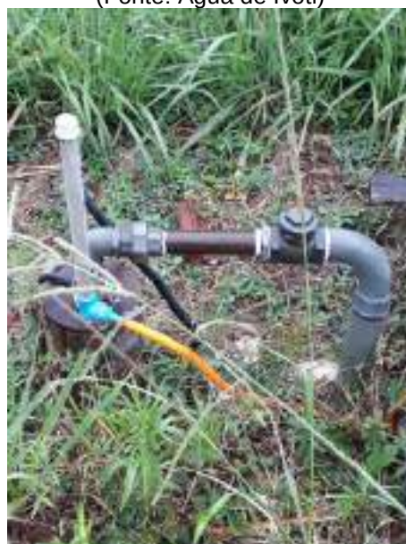
Figura 4-31: Poço Captação Bairro Nova Vila (Fonte: Água de Ivoti)
