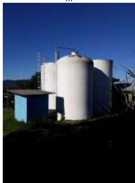
Figura IV-46: Reservatório água tratada 215 m 3
