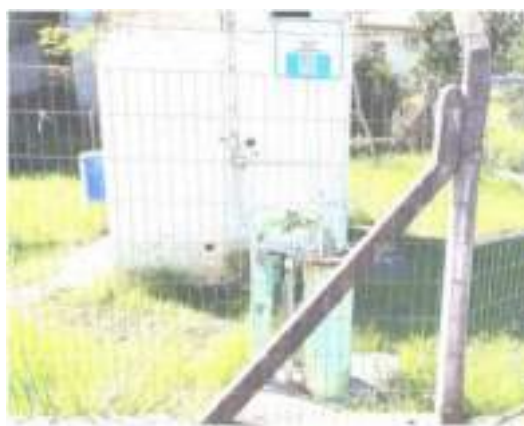
Figura 4-8: Ponto de captação (Fonte: Água de Ivoti)
