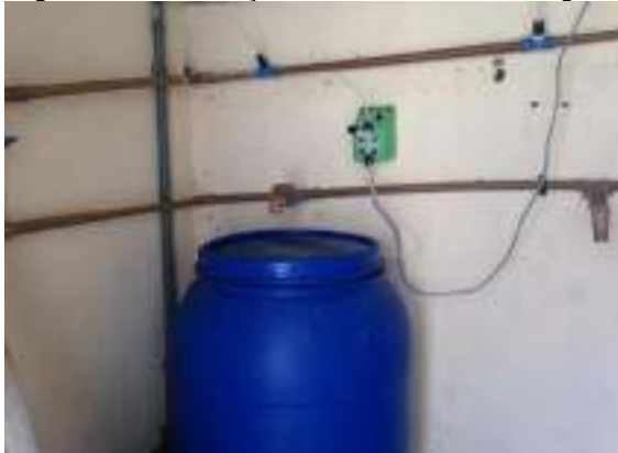
Figura IV-40: Estação de Tratamento de Água
