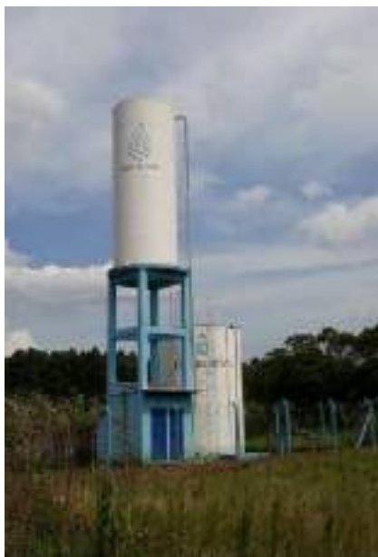
Figura 4-18: Reservatório água tratada 100m 3 (apoiado) 60m 3 (elevado) (Fonte: Água de Ivoti)
