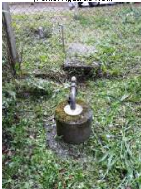
Figura 4-27: Poço Captação Bairro Picada 48 Alta (Fonte: Água de Ivoti)
