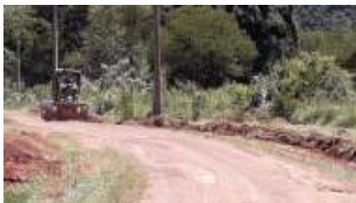
Figura 7-4: Drenagem Pluvial nas áreas rurais (Fonte: Prefeitura Municipal de Ivoti)
