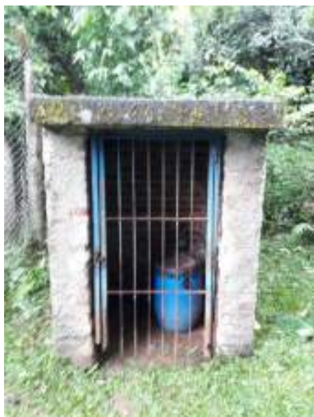
Figura 4-26: Poço Captação Bairro Picada 48 Alta (Fonte: Água de Ivoti)
