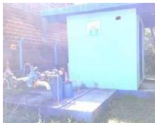
Figura 4-9: Ponto de captação (Fonte: Água de Ivoti)
