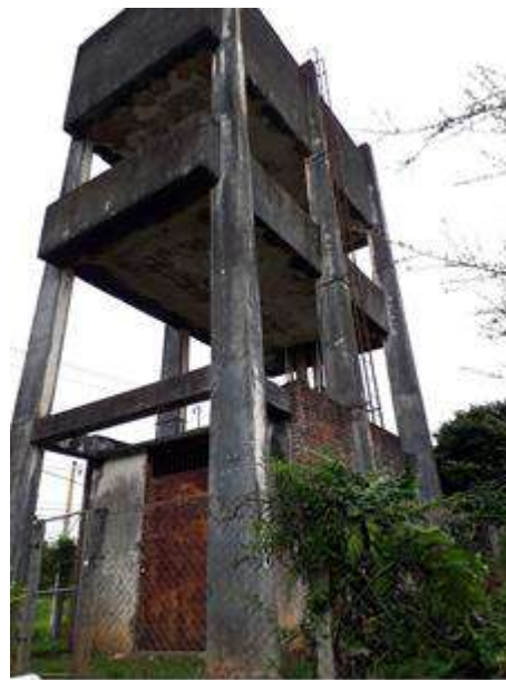
Figura 4-23: Reservatório Colônia Japonesa (Fonte: Água de Ivoti)
