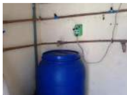
Figura 4-11: Estação de Tratamento de Água (Fonte: Água de Ivoti)
