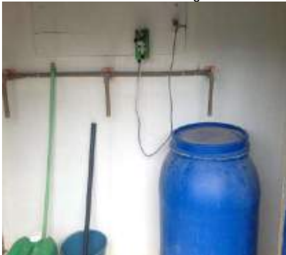
Figura IV-42: Sistema de cloração da Estação de Tratamento de Água
